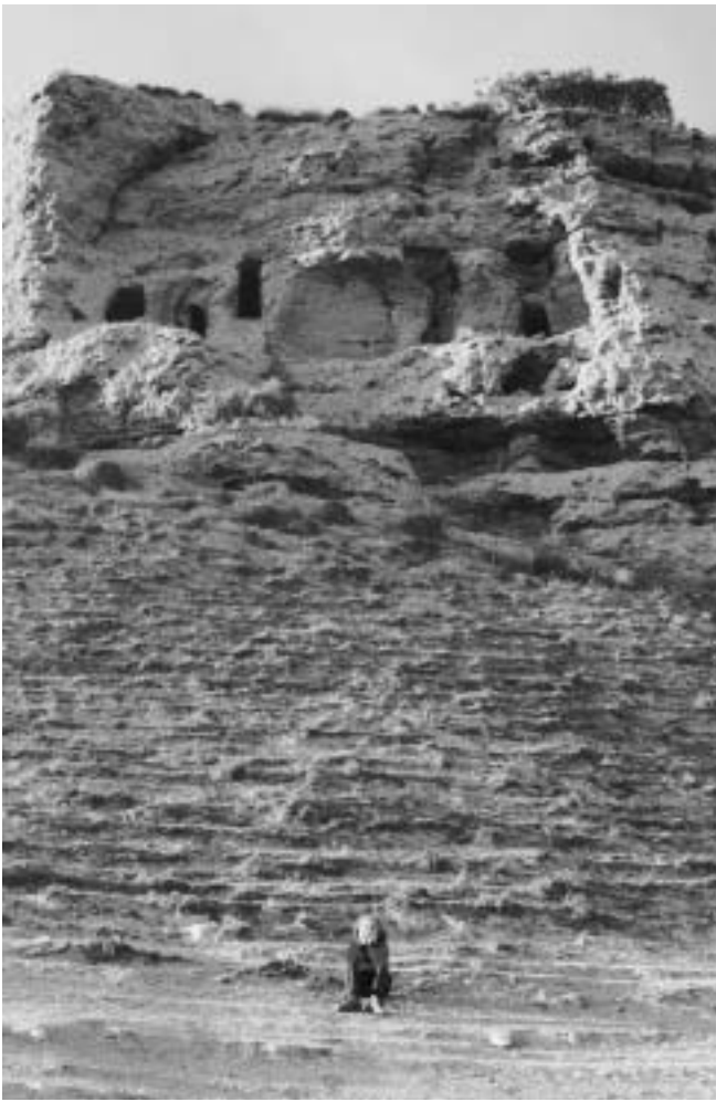
Fig. 12: Cuevas de los Castrejones. Colmenar de Oreja. Madrid. 1997. Se aprecia con claridad el desprendimiento de la pared de yesos donde se disponen las cuevas, y el interior ya destruido de una de ellas.
